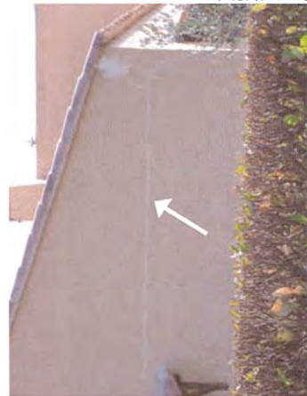
Source : Alp Géosciences. Fissuration traduisant un décollement de la structure par absence de liaisonnement entre niveau bas et comble.
